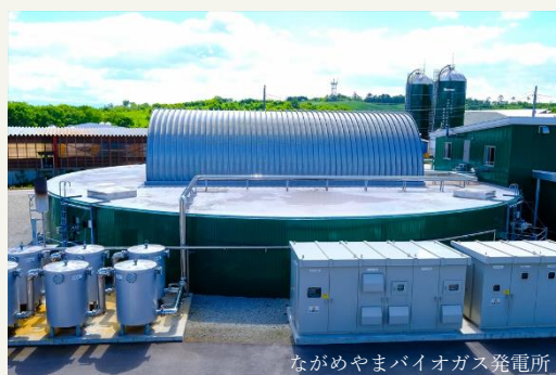
ながめやまバイオガス発電所
