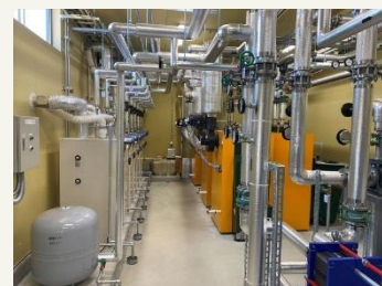
添川温泉しらさぎ荘 ボイラー室
