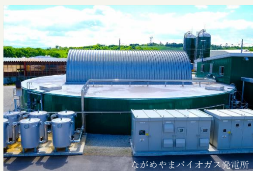
ながめやまバイオガス発電所
