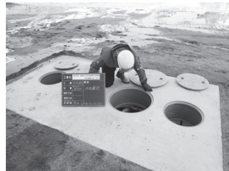
▲町が設置する合併処理浄化槽
